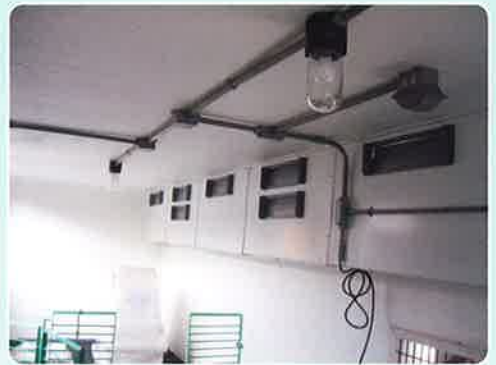
W400 の設置状況
